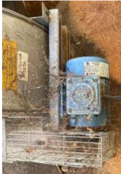
Figura 6 – motor elétrico da ventilação de ar.
