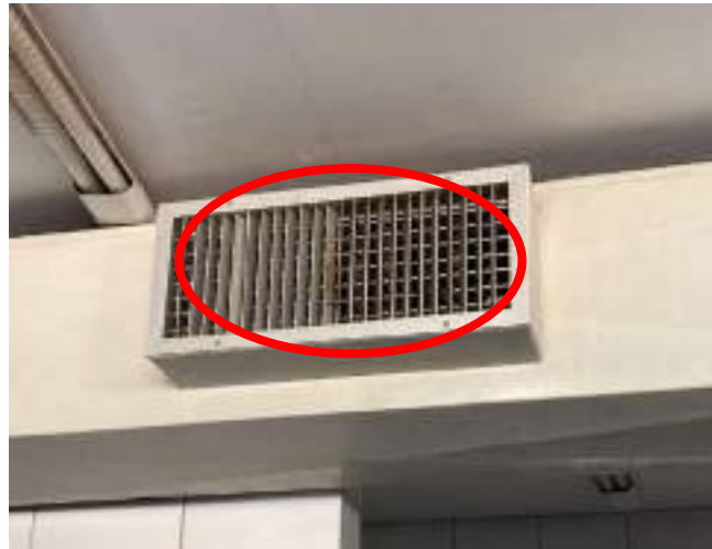
Figura 4 – Duto de ventilação.
