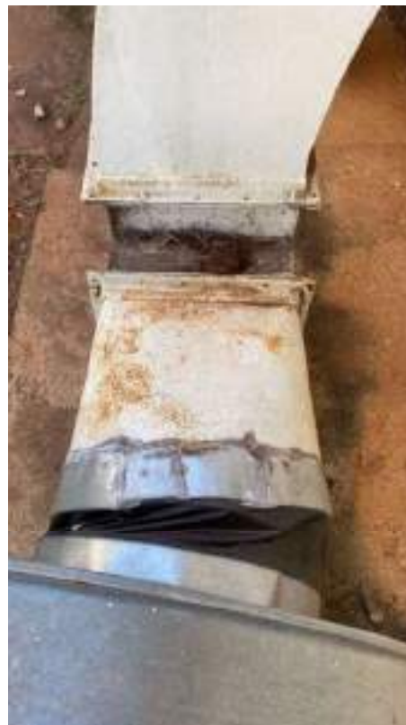
Figura 5 – Duto de ventilação de ar.
