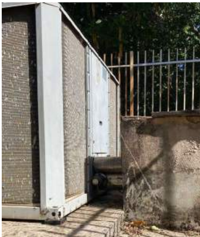
Figura 3 – Chiller Carrier vista lateral direita.
